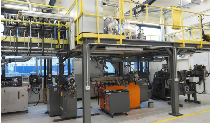
Im Technikum können bis zu fünf Anlagen gleichzeitig laufen. Die Materialzufuhr erfolgt durch Zuführungen aus der oberen Etage. © Hanser/Schröder
